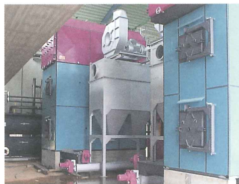
Holzfeuerungsanlage mit zwei Hochleistungskesseln mit einer Leistung von 1,5 bzw. 2,5 MW
